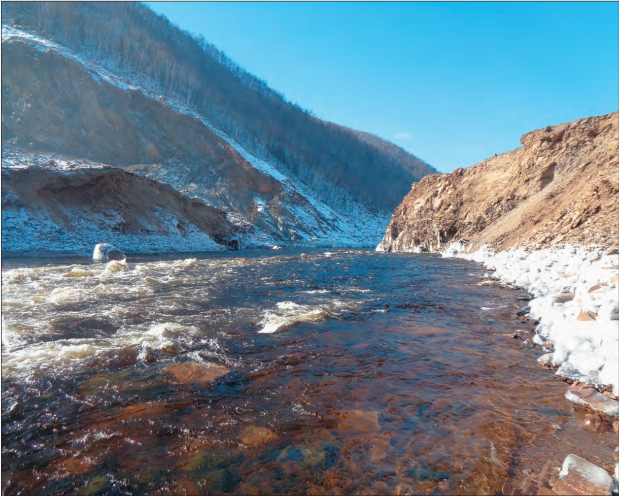
Искусственный канал в теле оползня. 1 марта 2019 г.
